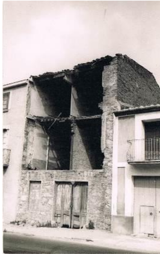
Estat en que va quedar l'edifici número 102 de la carretera Provincial després del bombardeig de l'any 1939 (Foto Família Niell, anys 60)
